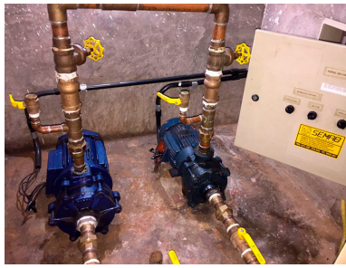
Conjunto motobomba, constituído pela bomba centrífuga, motor e quadro de comando 19
